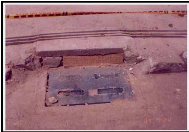
Figura 8.21 Protección de sumideros
